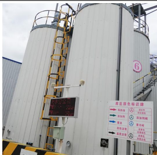
储罐及储罐区颜色识别牌
