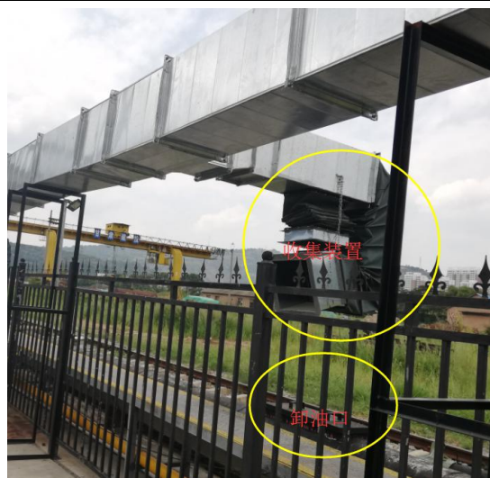
接卸仓废气收集
