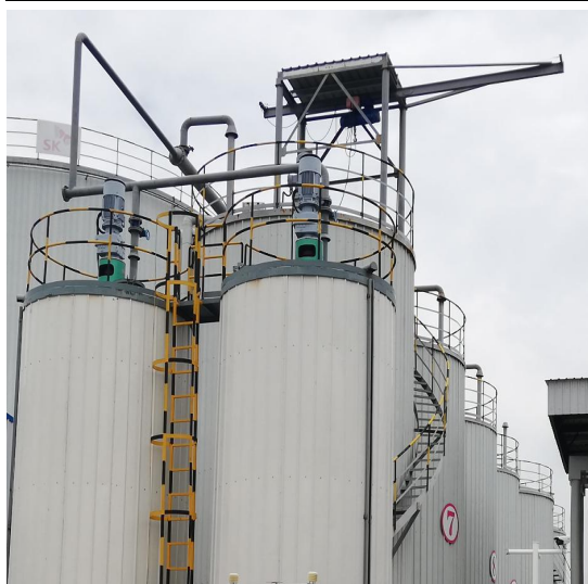
储罐油气回收
