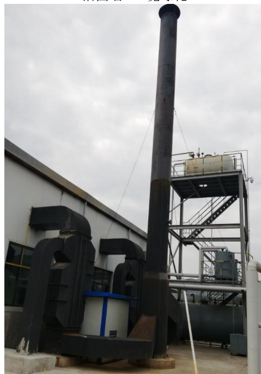
燃气锅炉烟气排气筒
