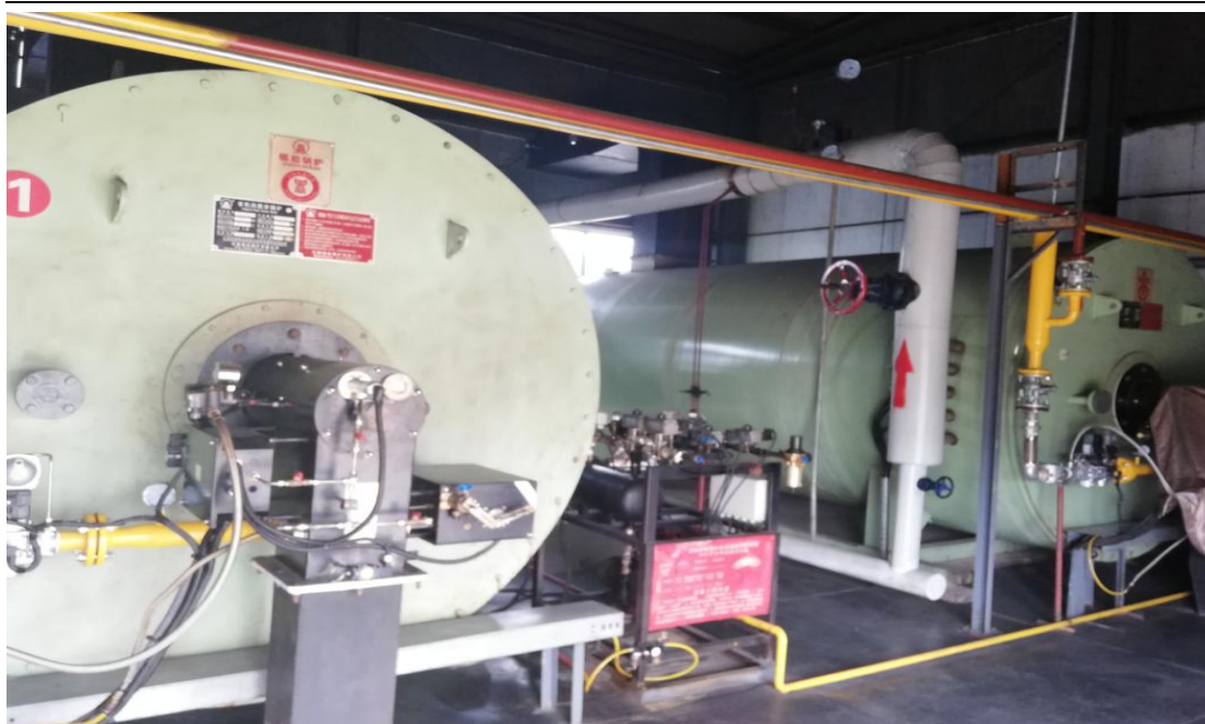
2 台导热油燃气锅炉
