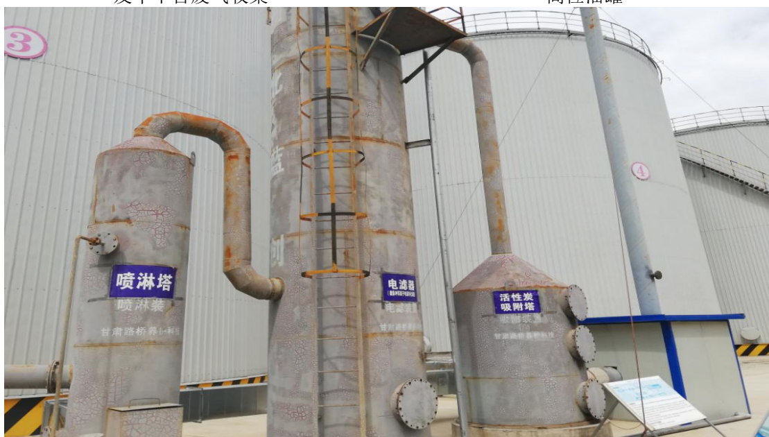
生产废气处理系统+风机隔音房
