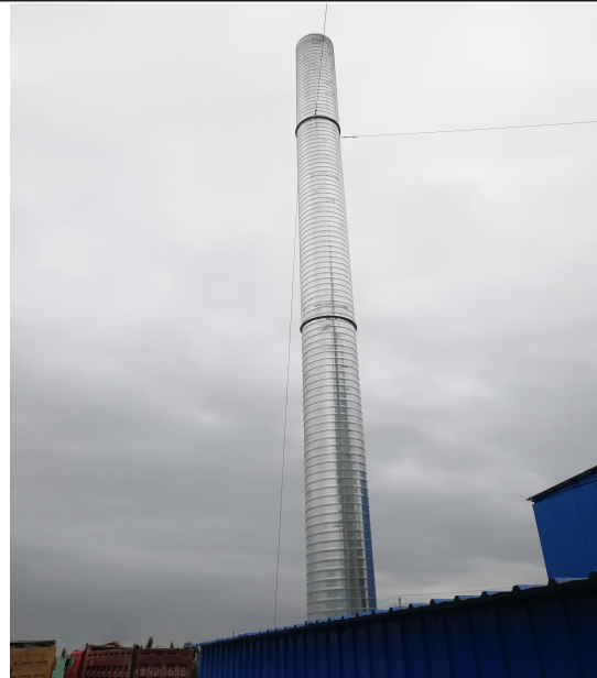
沥青生产线 排气筒
