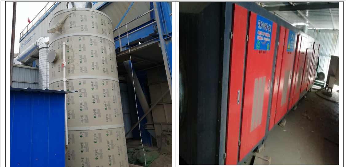
集气系统+钢制喷淋塔+等离子光氧催化装置
