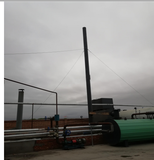
导热油炉排气筒
