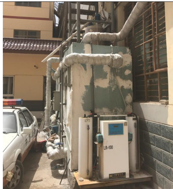
一体化污水处理站
