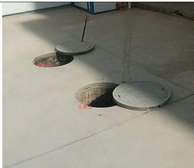
事故池+化粪池
