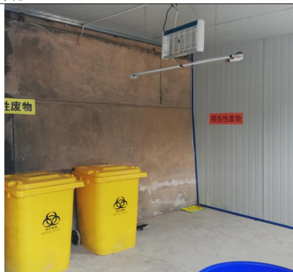
医废暂存间内部紫外消毒
