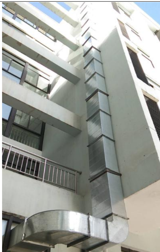
食堂油烟排气筒
