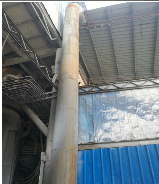
上配料仓集气管道
