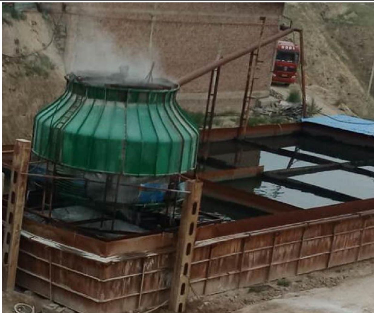
冷却塔及循环水池
