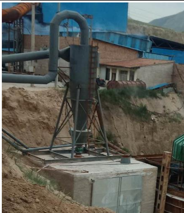
旋风除尘+灰尘沉降室
